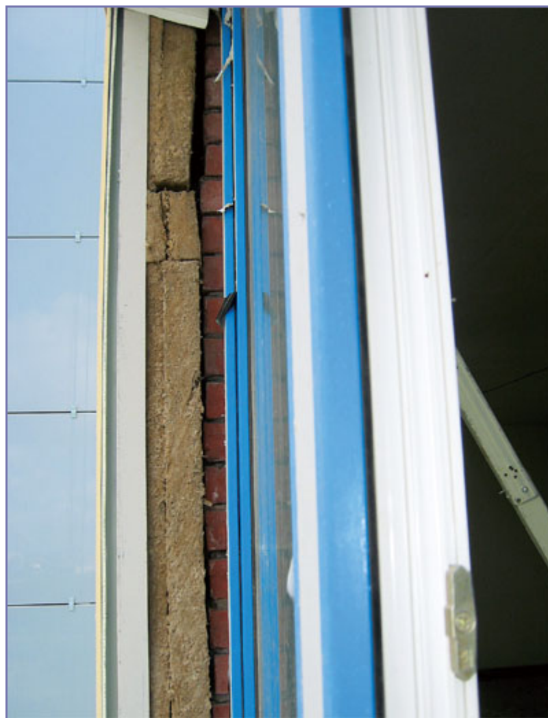
Рисунок 7. Неплотное прилегание минераловатных плит к стене в межоконном простенке
